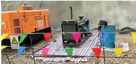
发电机油桶防渗措施
