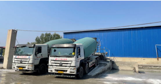
三级沉淀池污水集中处理
