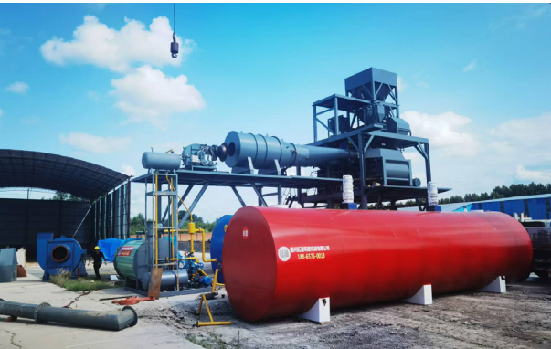
沥青拌合站使用清洁能源甲醇作为燃料
