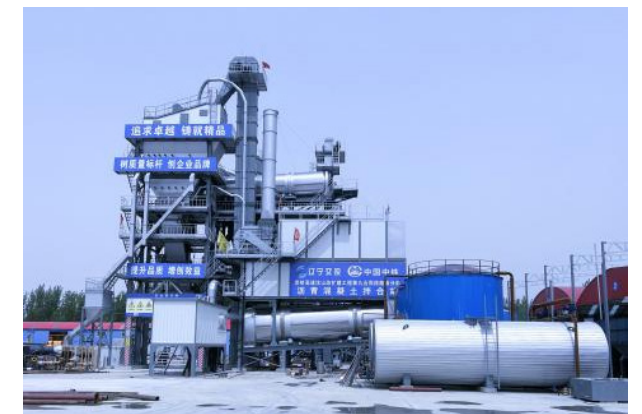
清洁能源沥青拌合站
